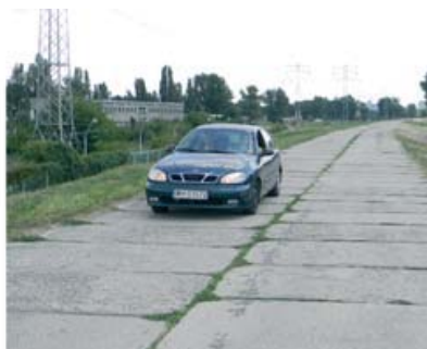
Rys. 5. Przejazd przez odcinek pomiarowy z nierównościami (Br).
